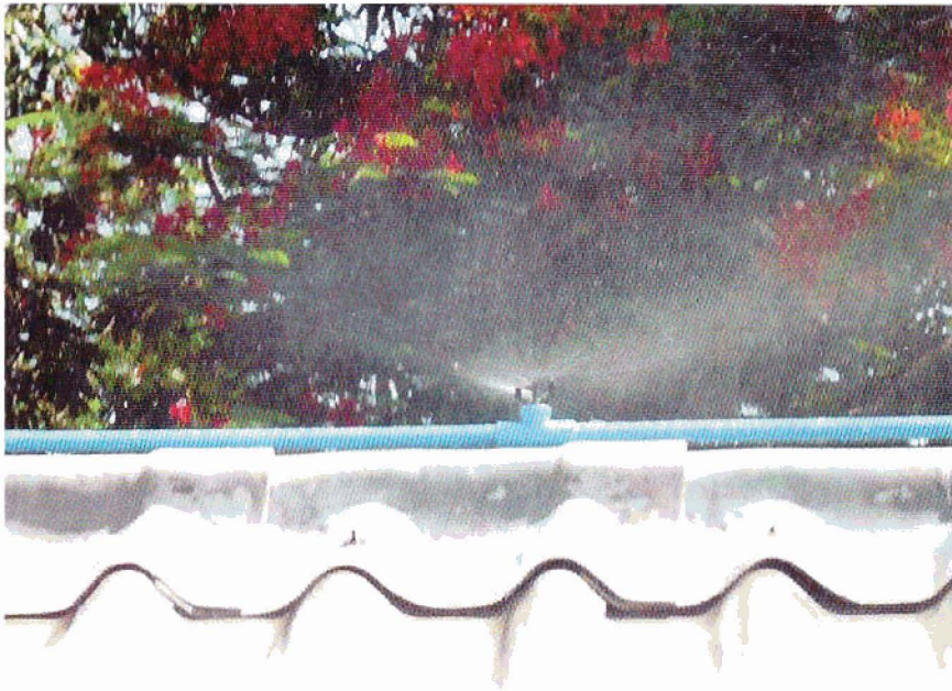
สปริงเกอร์ ลดความร้อนหลังคา
