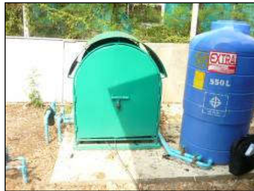
รูปที่ 22 เครื่องสูบน้ำและถังพัก
