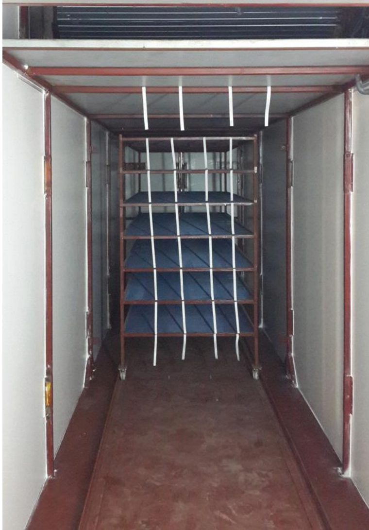
รูปที่ 18 วัดความเร็วลมที่ช่องลมด้านหลังรถเข็น
