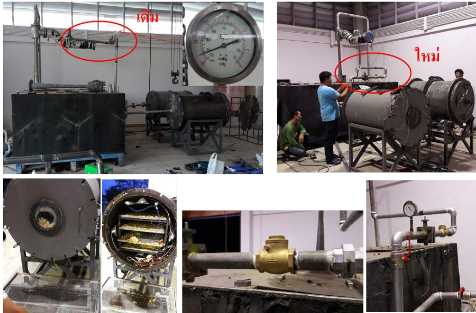
ภาพที่ 19 การติดตั้งวาล์วกันน้ำไหลย้อนกลับเข้าเครื่องอบแห้ง
