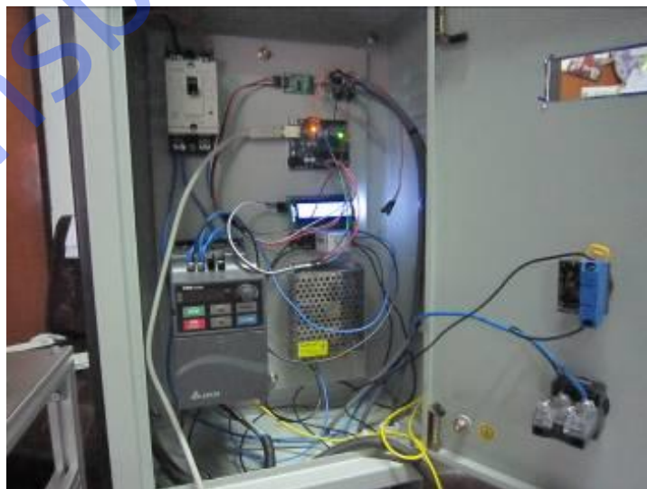
ภาพที่ 3.12 ตู้ควบคุมระบบไฟฟ้าหลักที่ติดตั้งบอร์ดควบคุมระบบอัตโนมัติ
