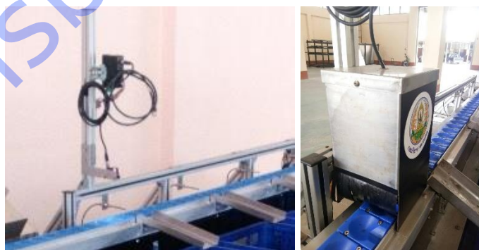
ภาพที่ 4.18 ติดตั้งห้องครอบตัวกล้องบนสายพานตัดแยก ก่อนปรับปรุง (ซ้าย) หลังปรับปรุง (ขวา)
