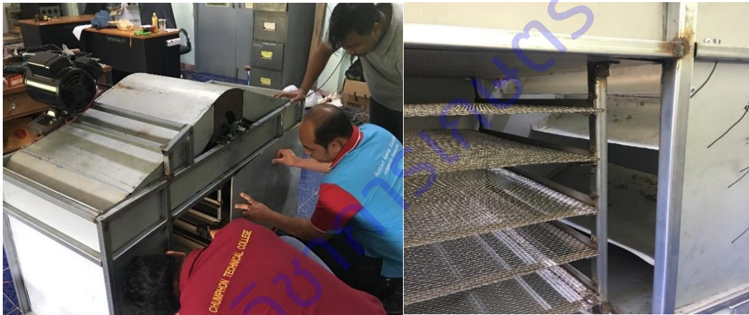
ภาพที่ 28 การทดสอบวัดความเร็วลม (ซ้าย) และการติดตั้งกระจายลมร้อน (ขวา)
